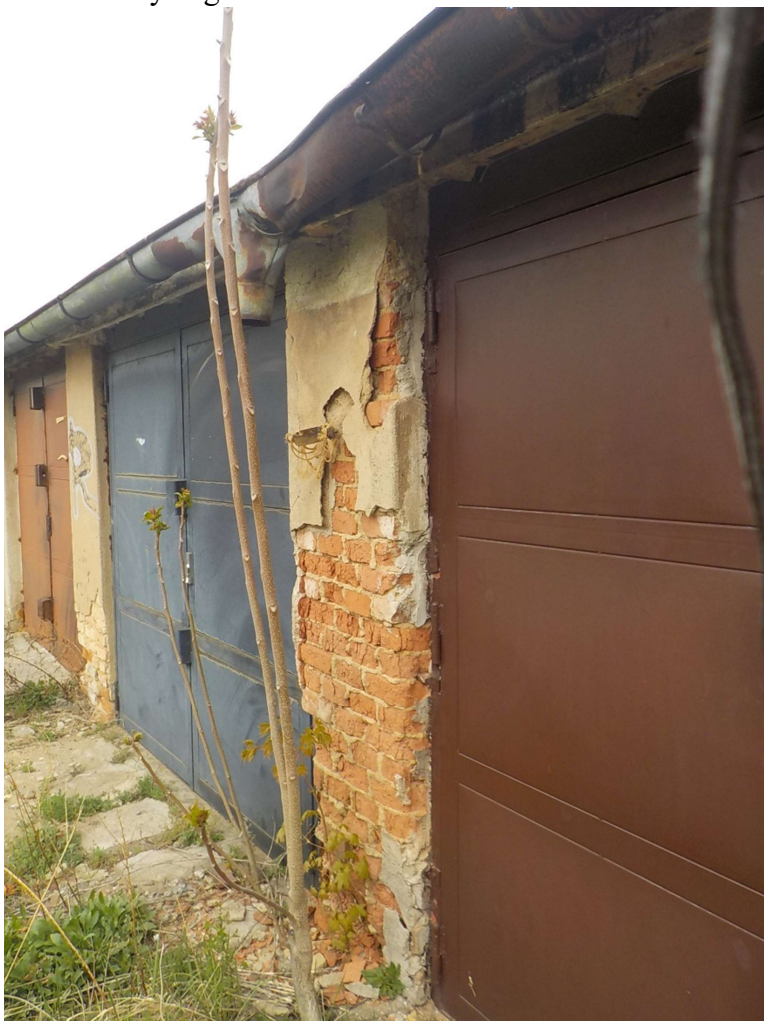
Stav některých garáží sousedících zadní částí s řadou obsahující parc. č. 2239/36, k. ú. Vršovice
