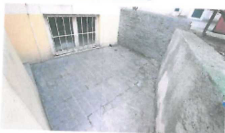
Porušená dlažba a opěrná zeď
