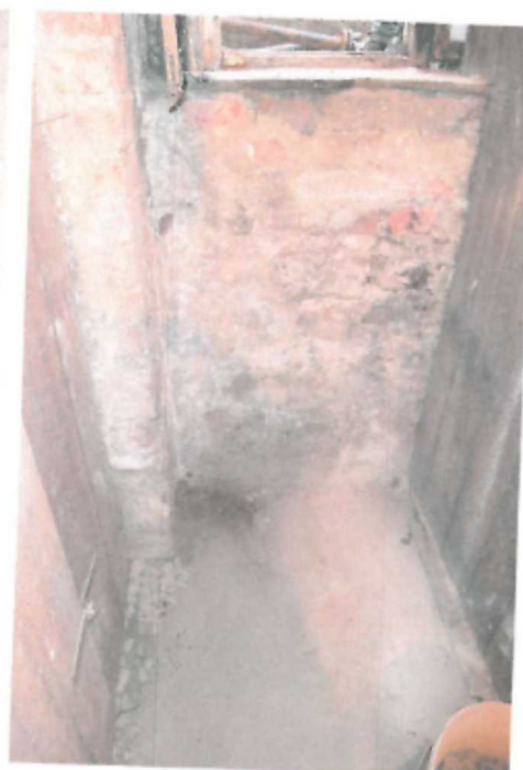
Poškozená vnitřní obvodová zeď objektu č.p. 829
