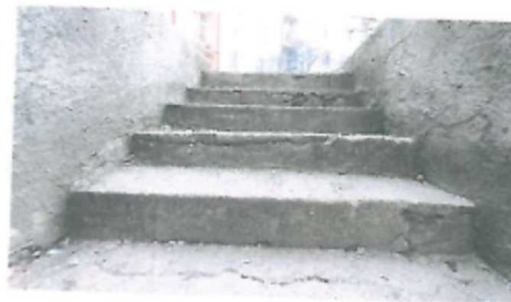
Klimatickými vlivy narušené schodišťové stupně
