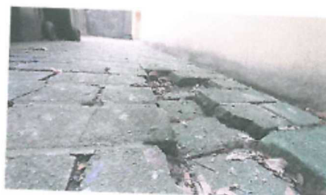
Propadá dlažba u objektu č.p. 829
