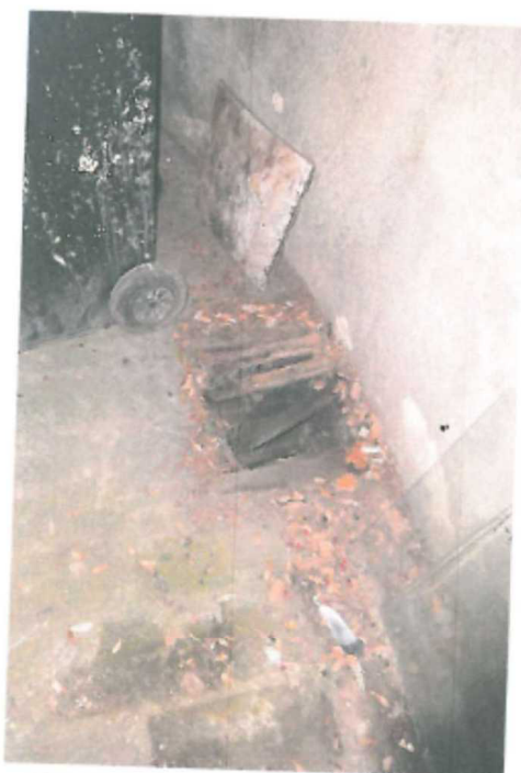
Chybějící poklop kanalizační vpusti a ucpaný odtok
