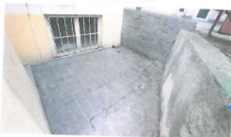
Porušená dlažba a opěrná zeď
