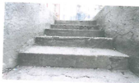
Klimatickými vlivy narušené schodišťové stupně
