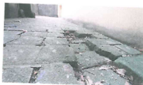
Propadá dlažba u objektu č.p. 829
