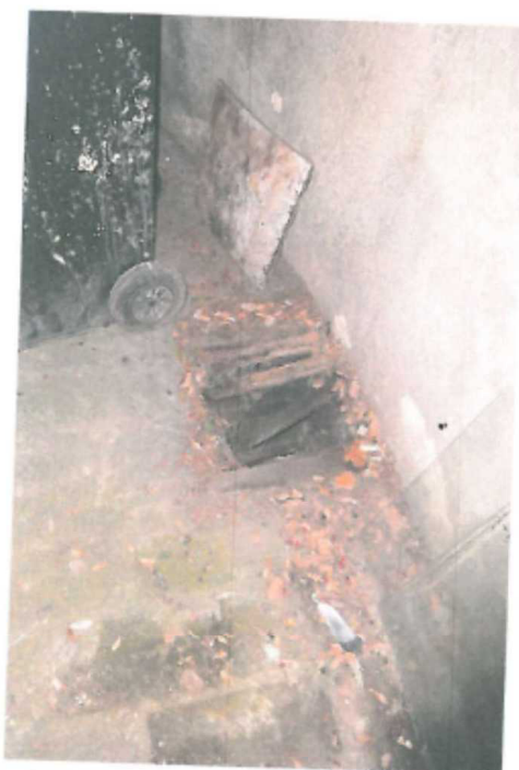
Chybějící poklop kanalizační vpusti a ucpaný odtok
