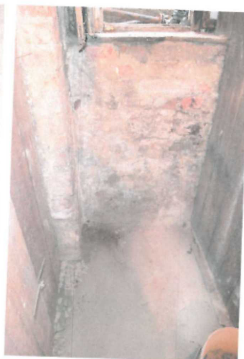
Poškozená vnitřní obvodová zeď objektu č.p. 829
