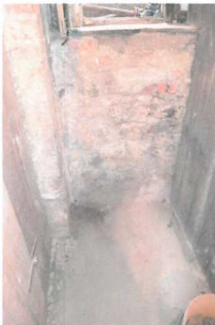
Poškozená vnitřní obvodová zeď objektu č.p. 829
