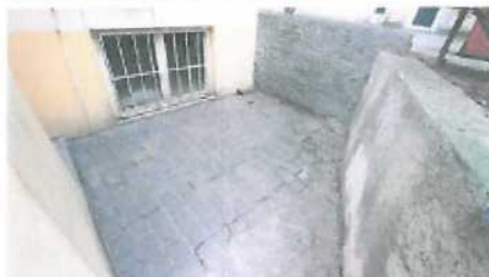
Porušená dlažba a opěrná zeď
