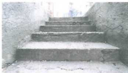
Klimatickými vlivy narušené schodišťové stupně
