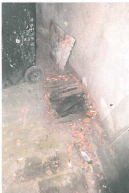
Chybějící poklop kanalizační vpusti a ucpaný odtok
