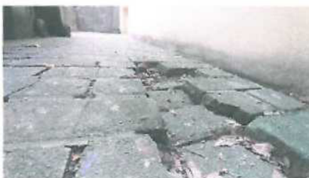
Propadlá dlažba u objektu č.p. 829
